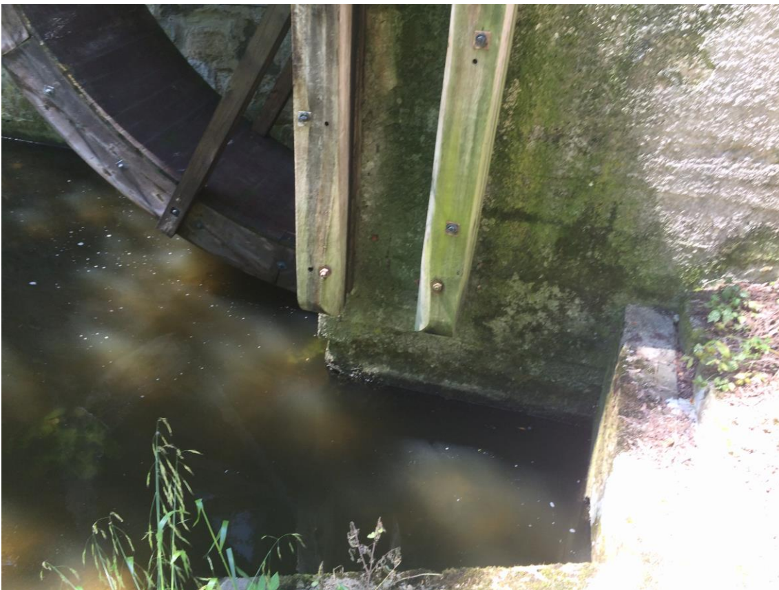
Ubytki w murze betonowym do wypełnienia (jaz) w pobliżu koła wodnego
