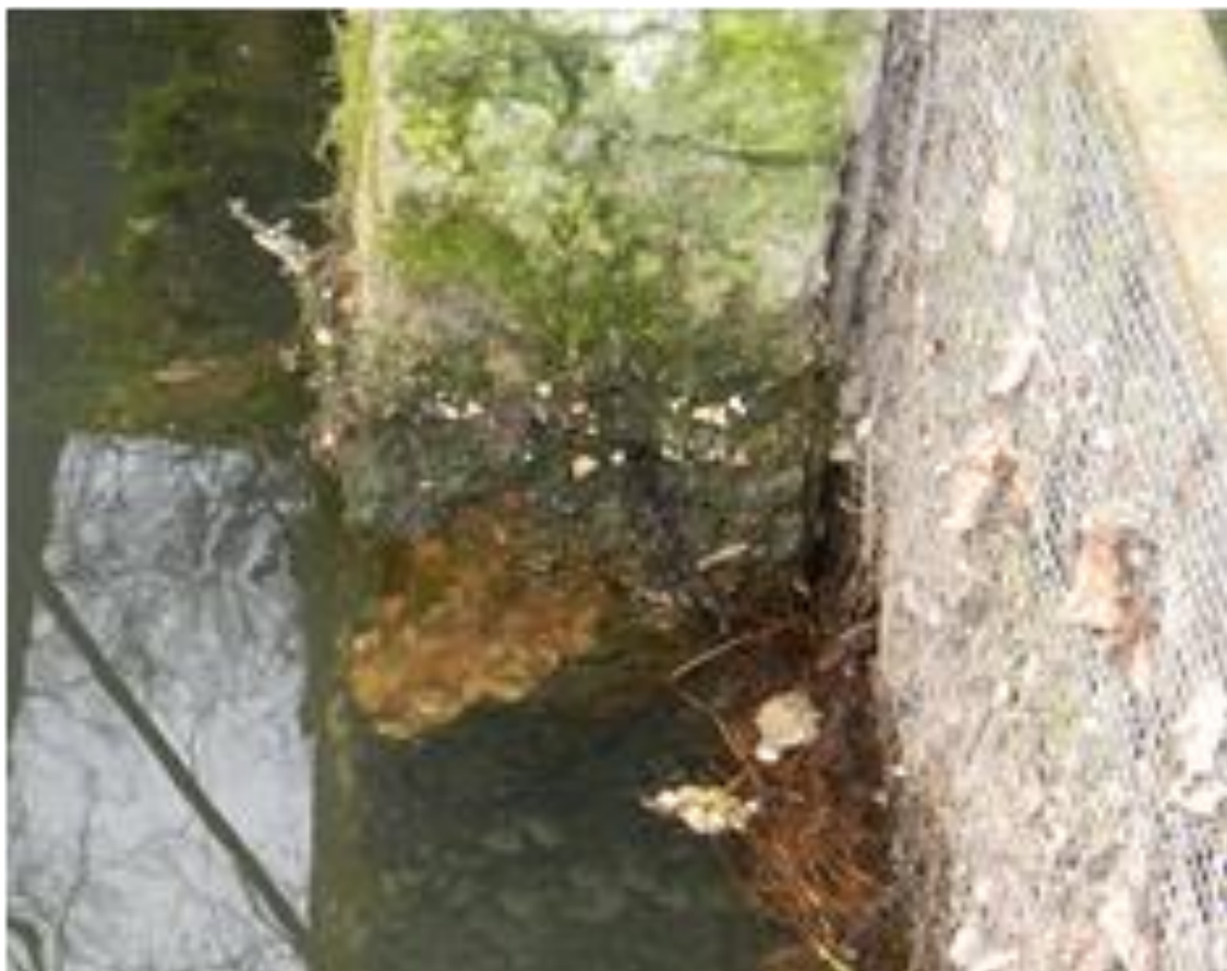
Ubytki w murze betonowym – przy wlocie jazu.
