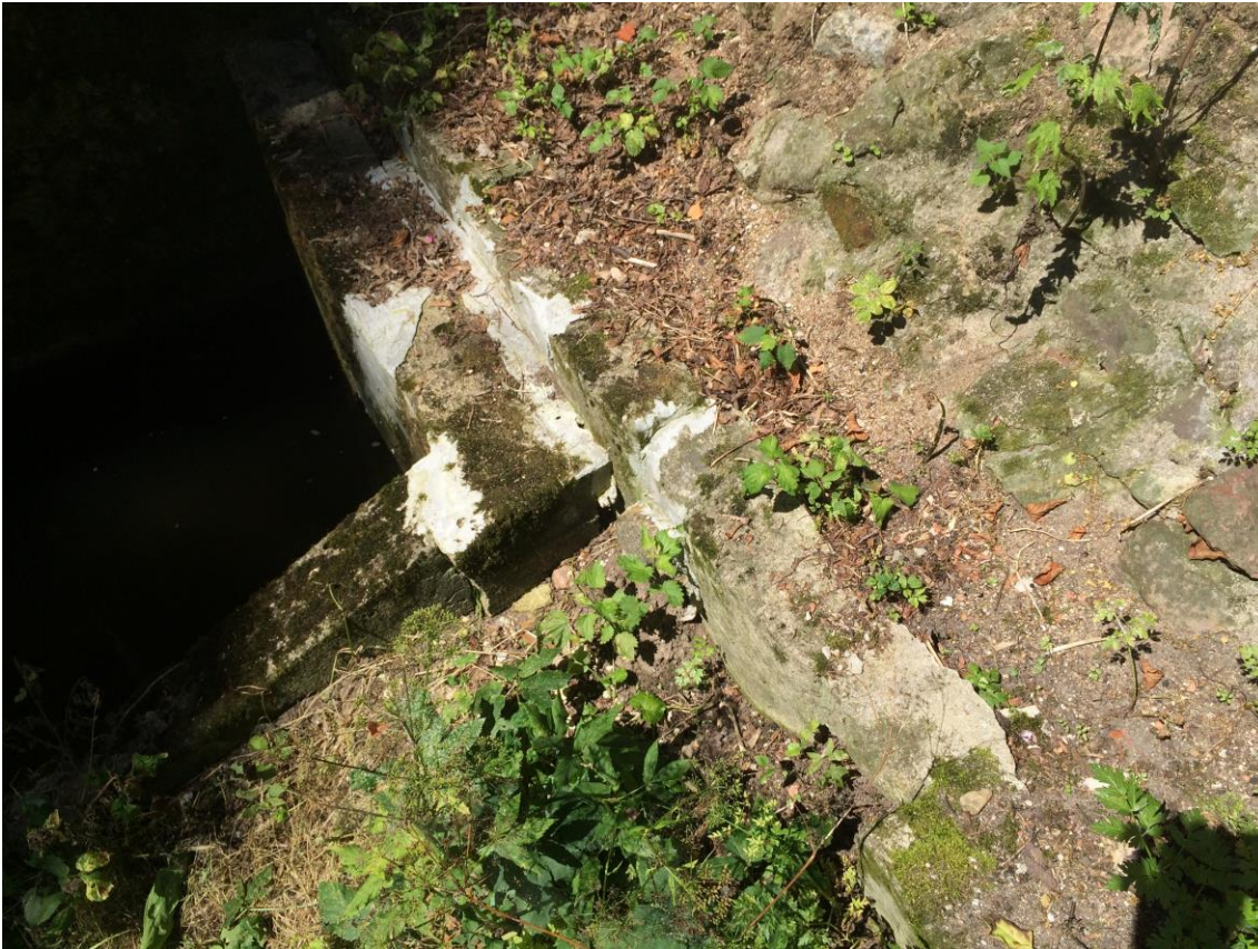
Zniszczenia murku przy kanale odpływowym.
