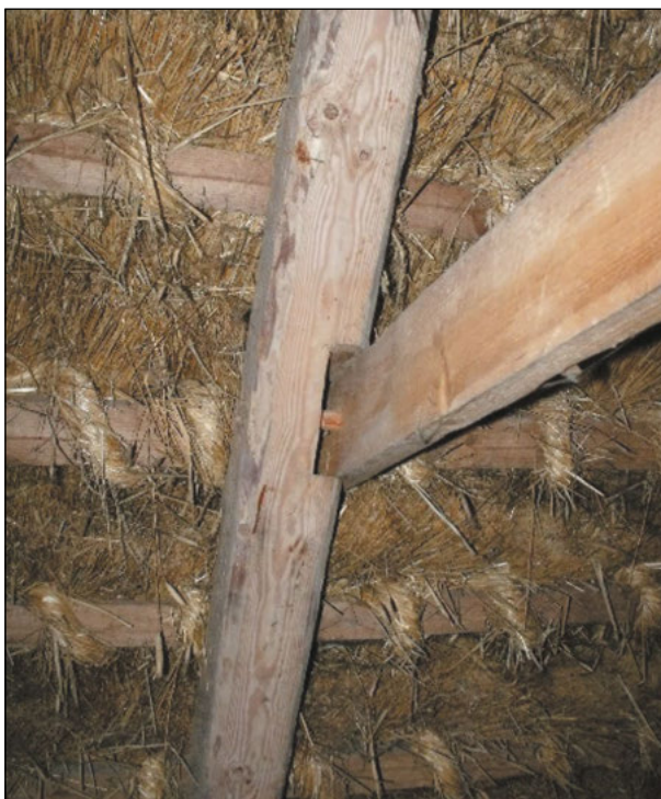
Fot. 3. Uszkodzone połączenie krokwi z jętką – chałupa z Żabna.
