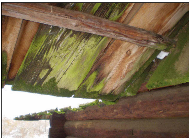
Fot. 7. Skutek nadmiernego zawilgocenia – stodoła ze wsi Bukowa.
