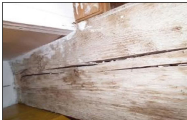
Fot. 2. Uszkodzona belka stropowa – spękanie podłużne – szkoła z Bełżca.
