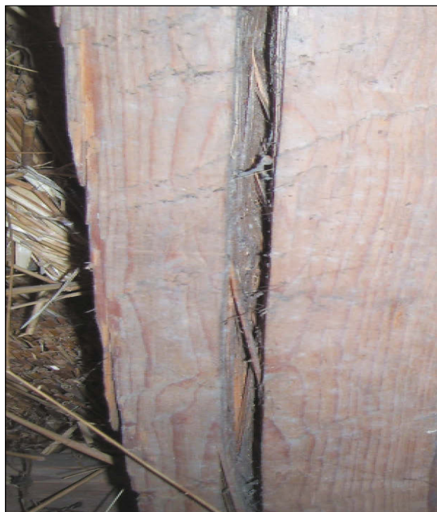
Fot. 4. Spękanie podłużne krokwi – chałupa z Teodorówki.
