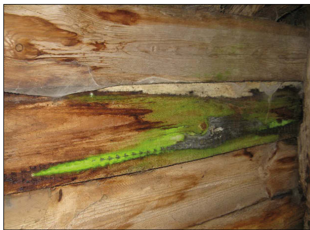
Fot. 8. Skutek nadmiernego zawilgocenia ściany – okólnik Urzędowa.
