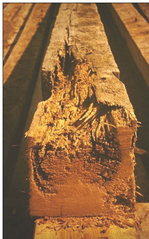
Fot. 3. Przykład fragmentu drewna konstrukcyjnego z rozkładem wewnętrznym, (fot. zbiory Zakładu Ochrony Drewna SGGW).
