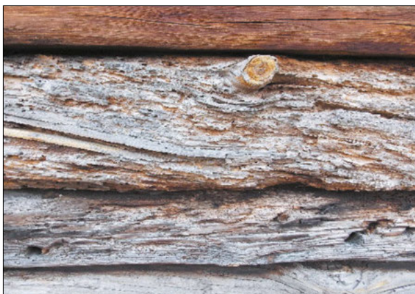
Fot. 5. Korozja biologiczna – chałupa z Janiszowi.
